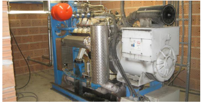
Blockheizkraftwerk mit einer Leistung von 250KWh thermische Energie; Foto: Florian Weinmann
